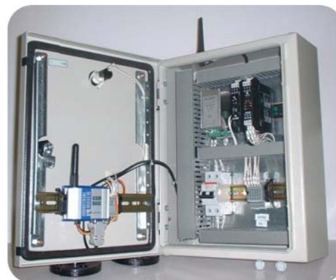
Figura 0-24 - telecontrollo unità di monitoraggio/controllo rete elettrica
