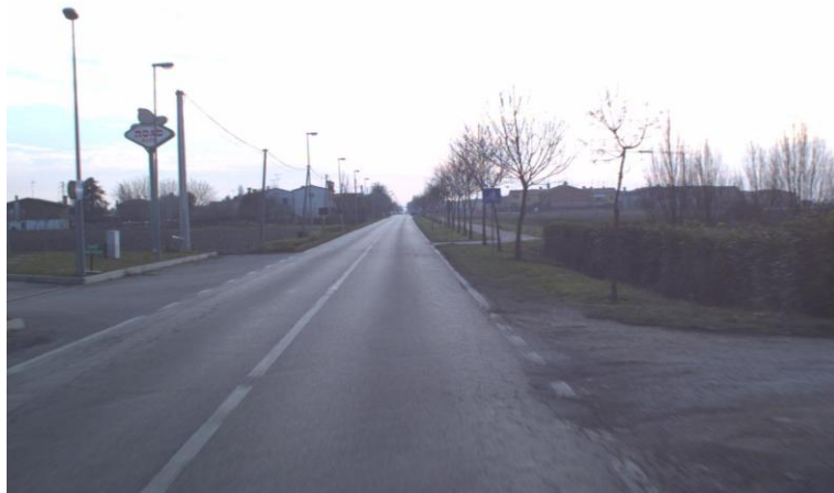
Figura 4: LIVELLO DI DEGRADO 3 – Presenza di segnaletica sbiadita ma leggibile.
