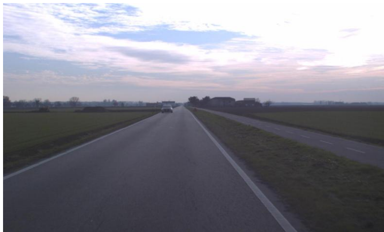
Figura 5: LIVELLO DI DEGRADO 4 – Segnaletica orizzontale leggermente sbiadita. In questo caso l'assenza della linea centrale non viene considerata come elemento negativo in quanto la larghezza della carreggiata è inferiore a 5,5m.
