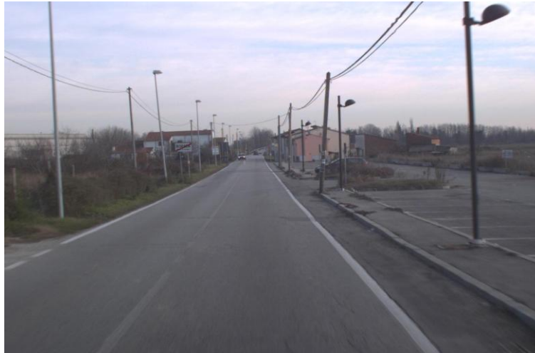
Figura 10: LIVELLO DI DEGRADO 3 – Si rileva la presenza di alcune fessurazioni a ragnatela e/o rappezi di varie dimensioni.
