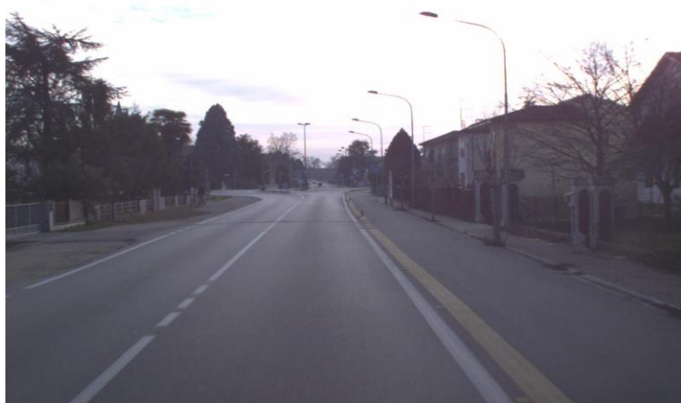
Figura 6: LIVELLO DI DEGRADO 4 – (Segnaletica orizzontale leggermente sbiadita).
