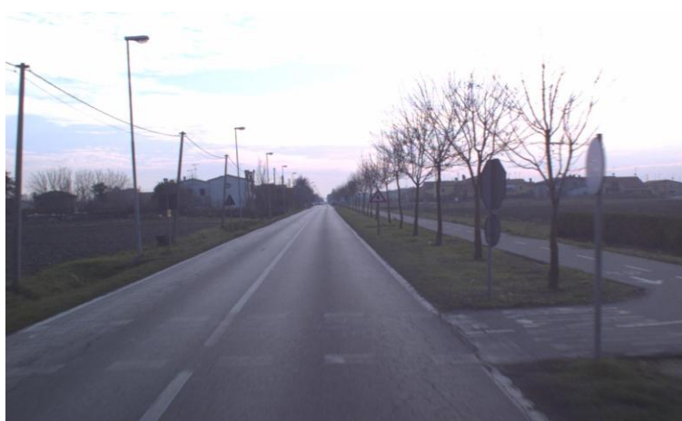
Figura 2: LIVELLO DI DEGRADO 2 – Presenza di un attraversamento pedonale o ciclabile molto sbiadito e illeggibile
