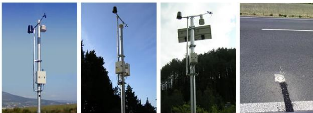
sistemi dedicati al controllo remoto della condizione del manto stradale (www.netsens.it)
